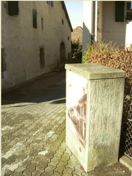
Armoire électrique, 2013, rue de Bernex
