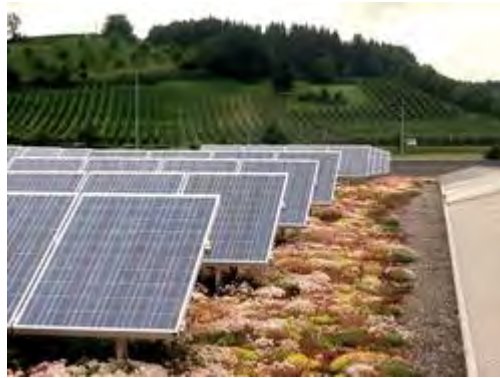
Figure 15 : Panneaux photovoltaïques sur un toit végétalisé [14]
