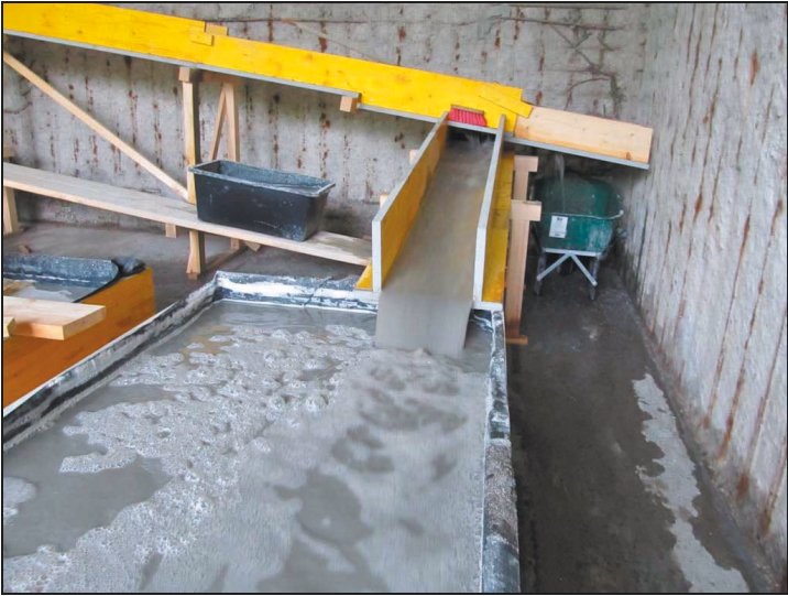
Figure 3: Installation de lavage et récupération des métaux denses par gravimétrie construite pour le premier test de 2017.
