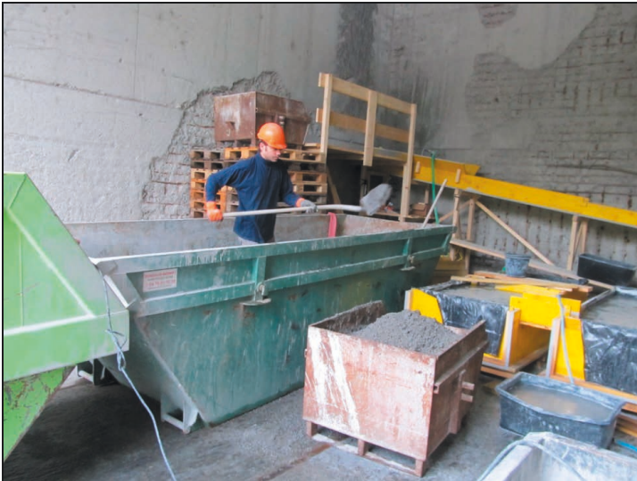
Figure 2: Installation de lavage et récupération des métaux denses par gravimétrie construite pour le premier test de 2017.
