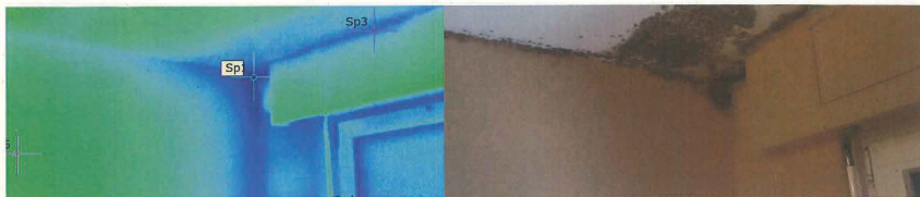
Moisissures apparues après un changement de fenêtres dans un immeuble ancien (caméra thermique et photographie).
