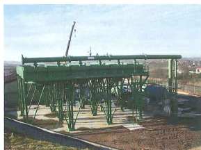
Figure 4 : Installation du système de refroidissement par air.
