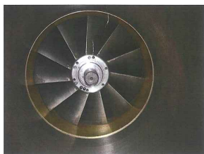
Figure 5 : Vue à l'intérieur de la turbine.
