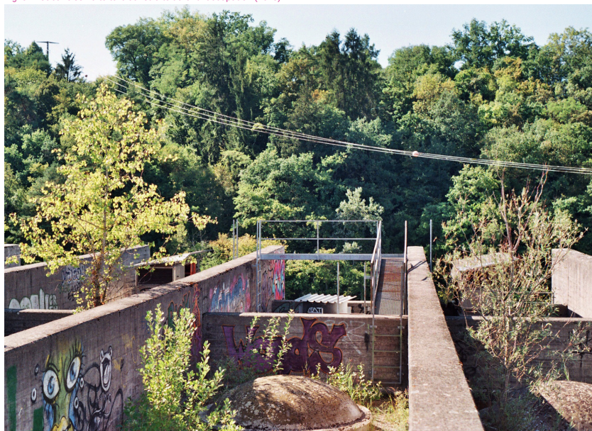
Fig. 32 - Toiture et végétation spontanée (2018)
