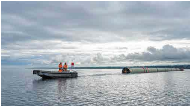
Conduites lacustres pour Genilac
