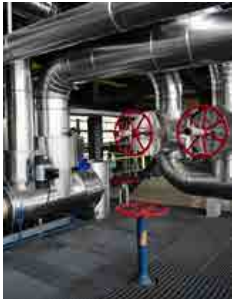
Chaudière du Lignon
