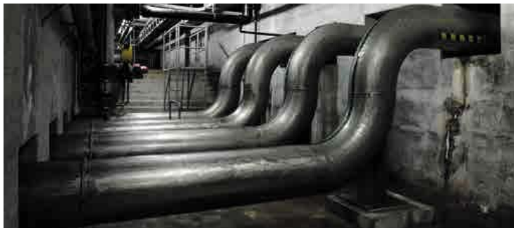
Conduites d'arrivée eau potable
