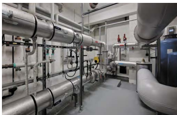
Chaufferie des immeubles Boudines 1 à 13
