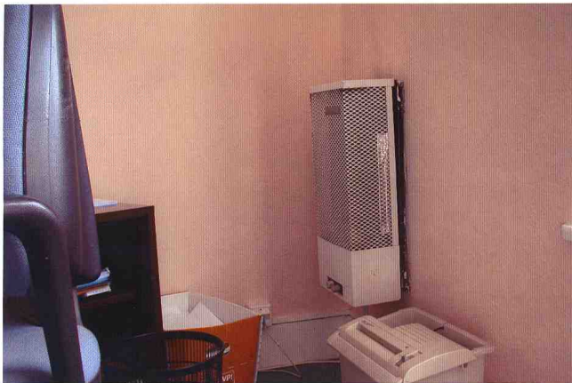
Radiateur à gaz dans un bureau du premier étage (extraction directement en façade)
