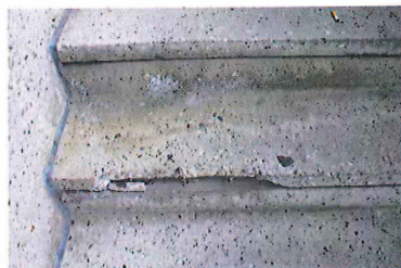
Le plafond suinte, s'effrite, l'armature rouillée voit le jour.
