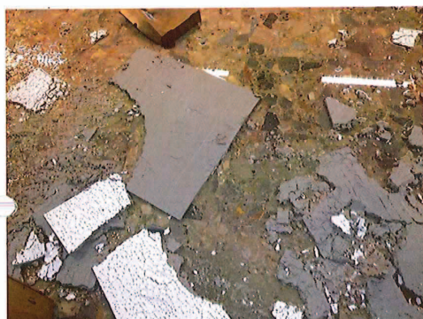
Plafond du foyer de l'aula est tombé au sol
