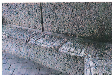
L'évacuation de l'eau de pluie est obstruée.
