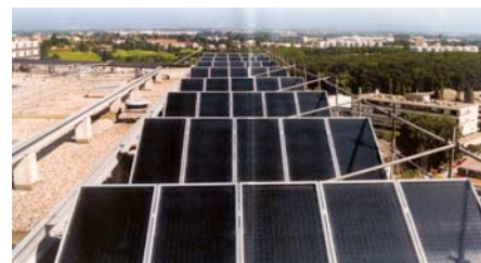
Panneaux solaires en toiture
