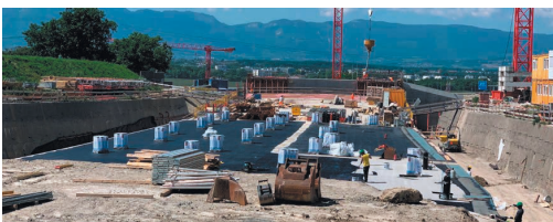
Travaux de liaison entre la route des Nations et la jonction autoroutière
