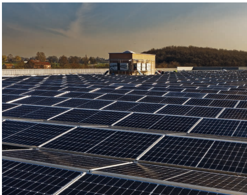
ZI du Bois-de-Bay : toiture solaire photovoltaïque
