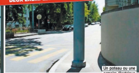
Un poteau ou une armoire électrique au beau milieu du trottoir, c'est moche et mal pensé.
