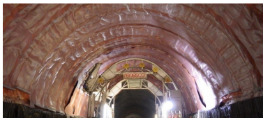
Étanchéité de la voute
