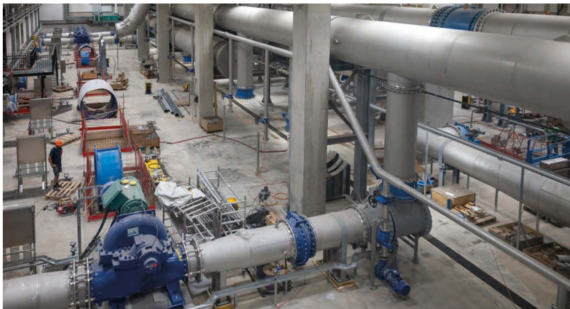
Station de Pompage du Vengeron
