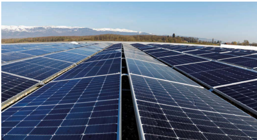
Centrale solaire de la FTI
