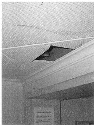
Une plaque du plafond cassée dans l'entrée du no 25 dont le modèle doit être difficile à retrouver.
