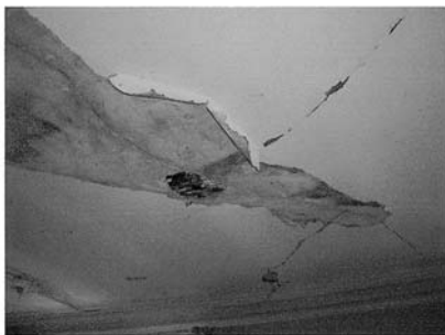
14 Dégât d'eau au plafond aux combles .jpg
