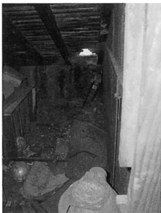
17 Défaut en toiture .jpg
