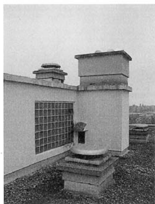
Locaux techniques en toiture : ferblanteries, toitures et maçonneries détériorées.
