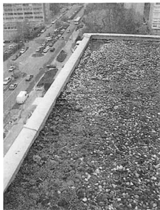
Toiture sans entretien, l'étanchéité est découverte par endroits. La ferblanterie est en bon état.
