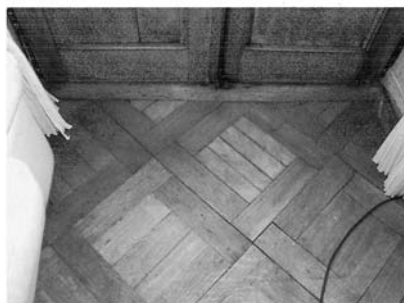
20 Dégât d'eau - parquet déformé au 3ème étage .jpg
