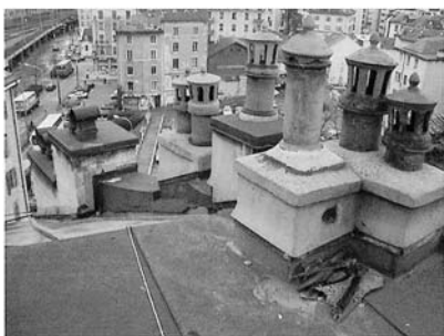
7 Souches sur mur mitoyen.jpg
