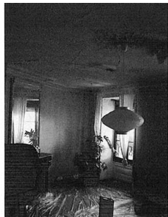
21 Dégât d'eau - séjour dans les combles .jpg
