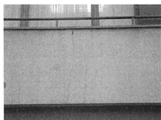
Allège préfabriquée BA fissurée
