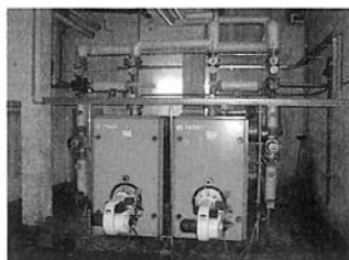
Chaufferie récemment refaite.
